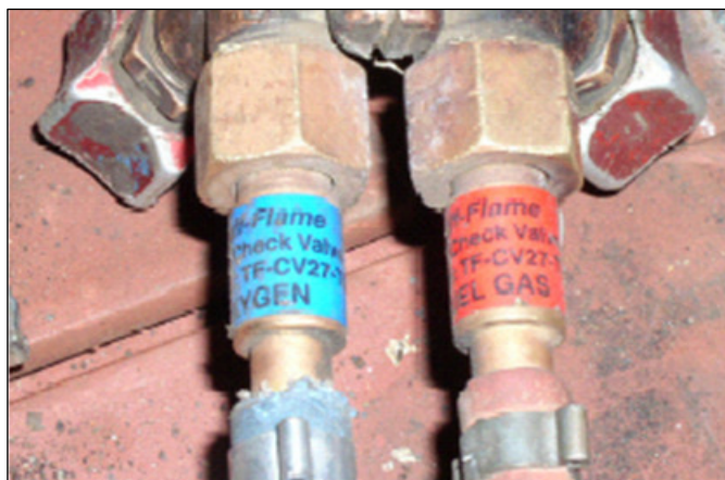
รูปที่ 8 การติดตั้งอุปกรณ์ป้องกันไฟย้อนกลับที่บริเวณทางออกของวาล์วปรับความดันและหัวเชื่อมก๊าซ
